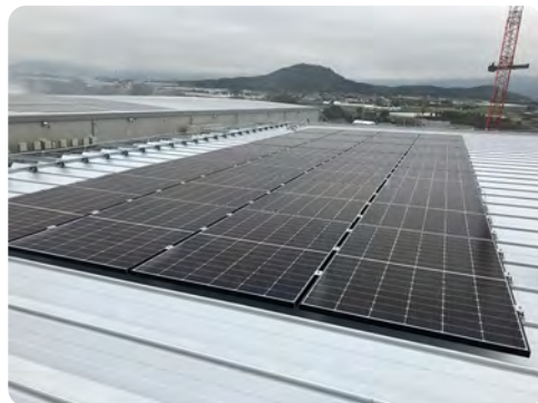
KRD-Logistics 福岡小郡（福岡県小郡市）の屋上に設置した太陽光発電パネル
