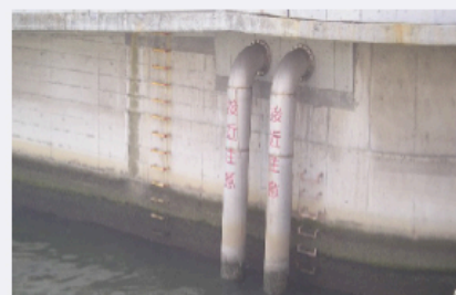
河川水取水管
